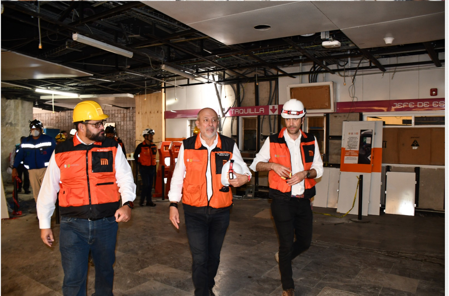
Esta mañana, el Secretario de Movilidad de la Ciudad de México, Andrés Lajous Loaeza, y el Director General del Metro, Guillermo Calderón Aguilera, llevaron a cabo un recorrido de supervisión de avances en las obras del segundo tramo de la Línea 1 que se encuentra en modernización.
